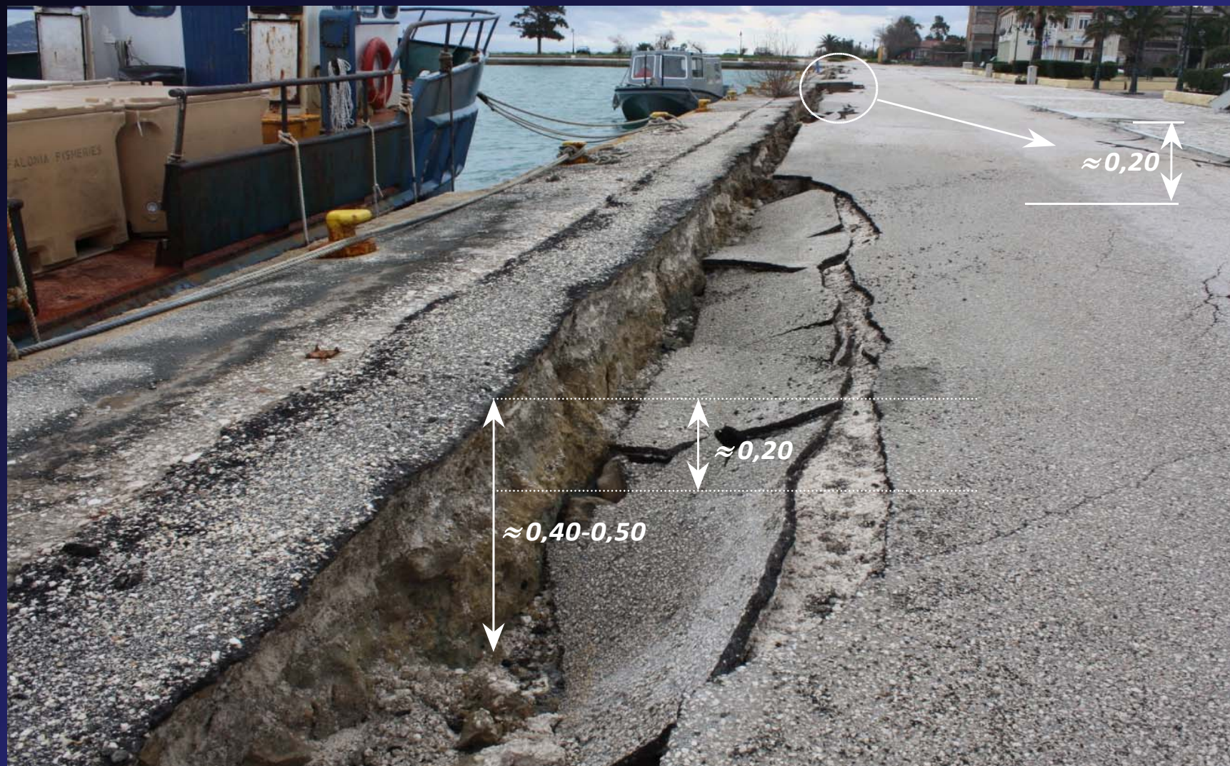
Καθίζηση όπισθεν των κρηπιδοτοίχων
