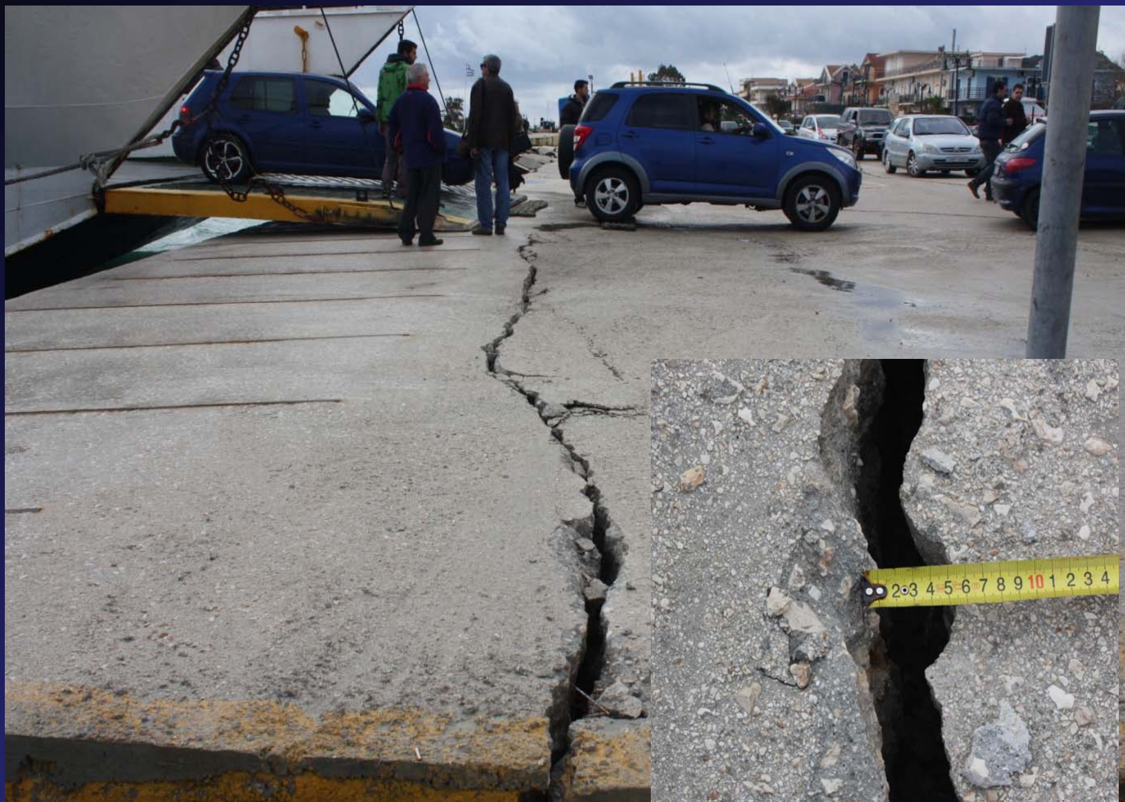
Ρηγμάτωση ράμπας λόγω μεγάλου εφελκυσμού από τη λειτουργία της ως ελκυστήρα
