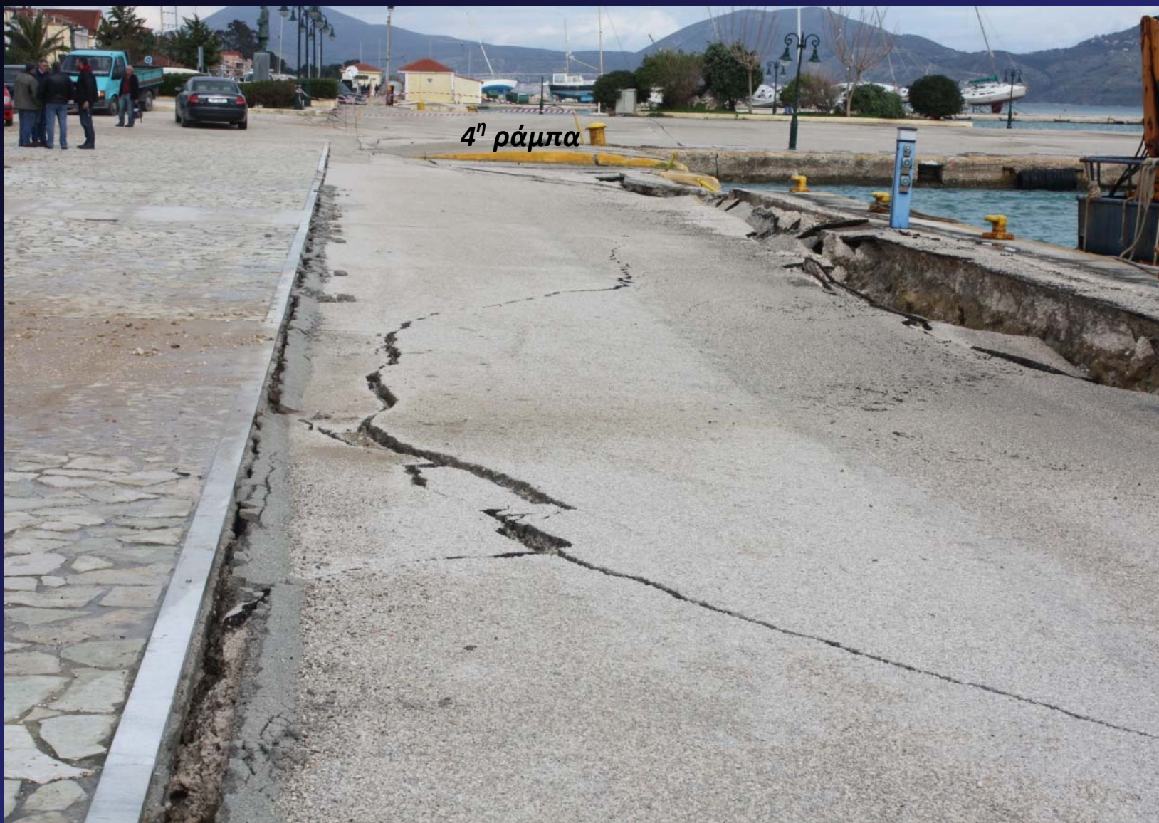
Γενική αστοχία εδάφους λόγω μεγάλης μετακίνησης ή/και στροφής των κρηπιδοτοίχων
